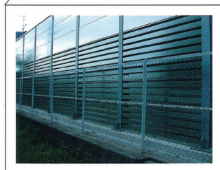
【遮音ルーバー】
