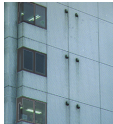
■従来型換気口による壁の汚れ (雨垂れによる)
